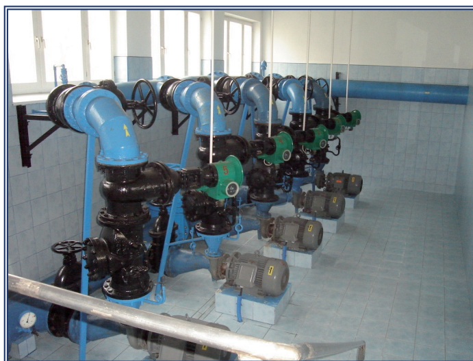
Rys. 3. Wodociąg publiczny Turek (raportowany do Komisji Europejskiej) – Stacja uzdatniania wody - odżelaziacze
