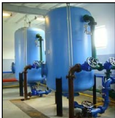
Rys. 9. Wodociąg publiczny Gozdowo (powiat wrzesiński) –Stacja Uzdatniania Wody
