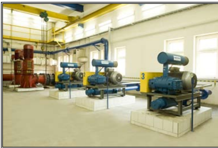
Rys. 5. Wodociąg Ostrów Wlkp. – pomieszczenie sprężarek
