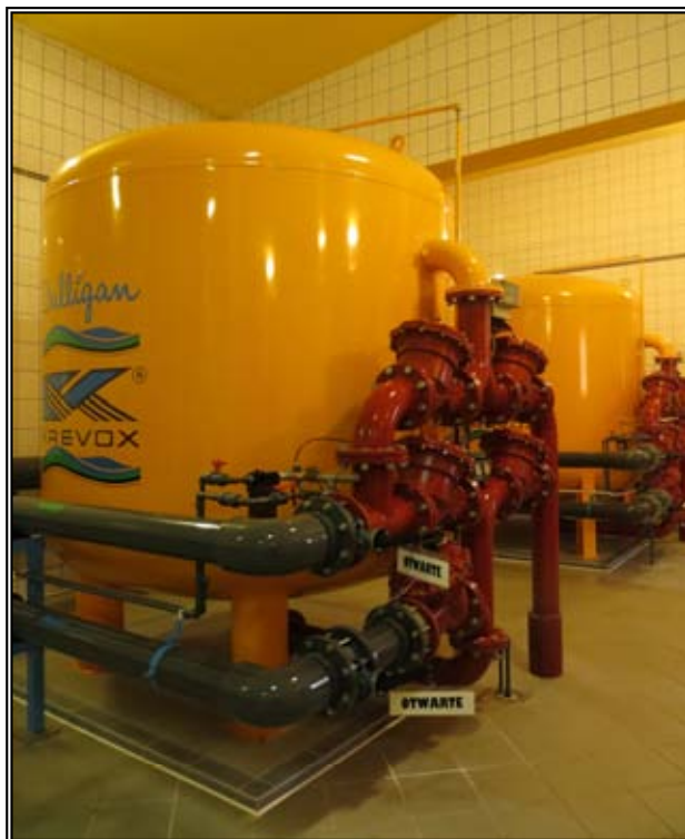
Rys. 6. Stacja Uzdatniania Wody – Wodociąg publiczny Nowy Tomyśl
