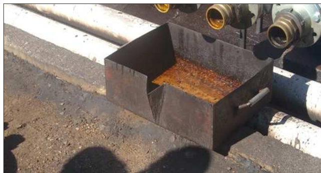
Fot. Ujawnione w trakcie oględzin miejsce punktowego zanieczyszczenia gruntu.
