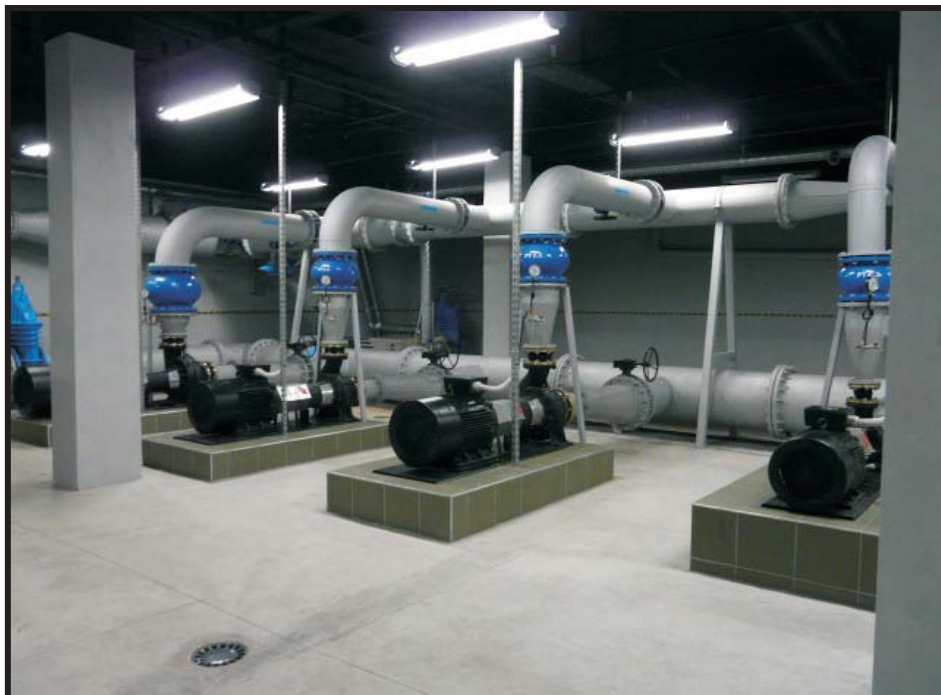
Rys. 6. Wodociąg Kalisz - Stacja Uzdatniania Wody Lis - pompownia
