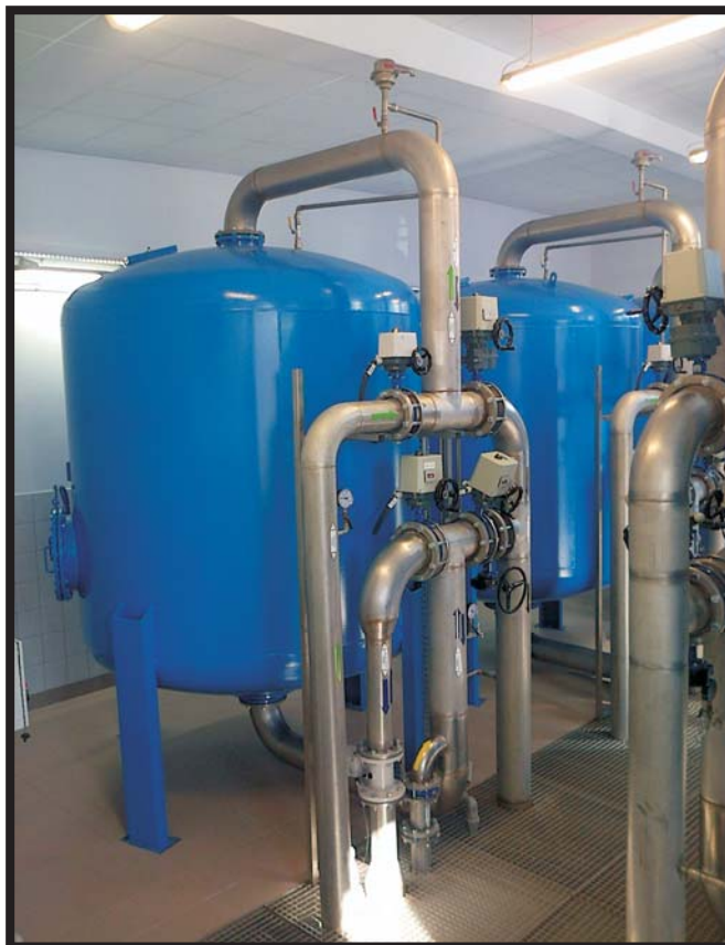
Rys. 3. Wodociąg publiczny Szamotuły (raportowany do Komisji Europejskiej). Stacja uzdatniania wody – hala filtrów
