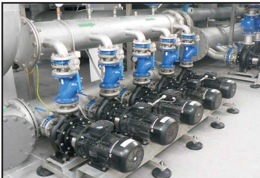
Rys. 7. Wodociąg publiczny Leszno - Stacja Uzdatniania Wody Zaborowo - pompownia
