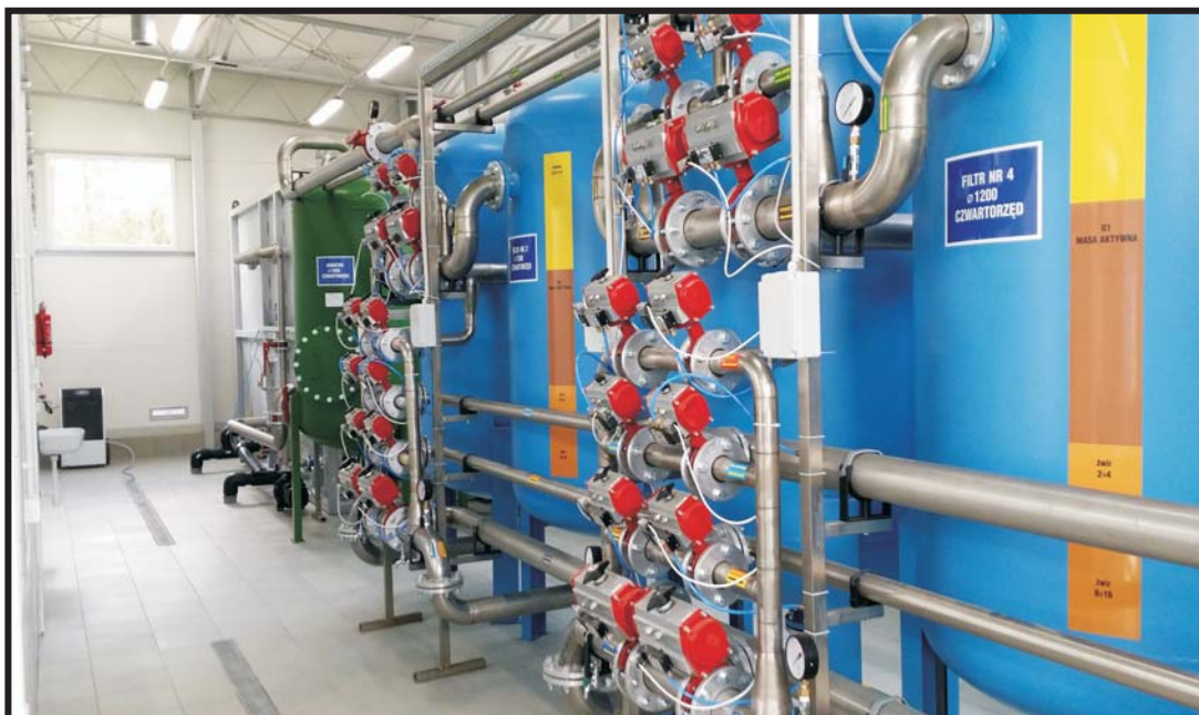
Rys. 11. Wodociąg publiczny Mikoszki - Stacja Uzdatniania Wody (powiat kościański)
