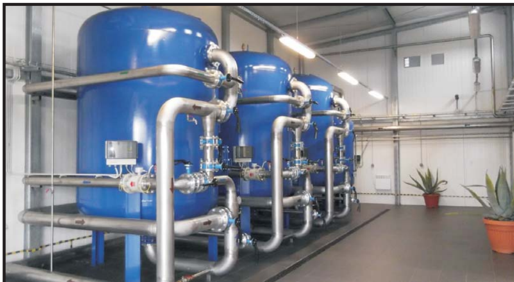
Rys. 14. Wodociąg publiczny w Dziekwoluczu - Stacja Uzdatniania Wody - hala filtrów (powiat chodzieski)
