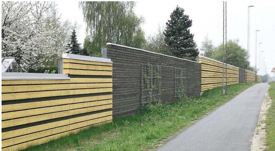
Rys. 18. Ekran przeciwhałasowy (drewniany)
