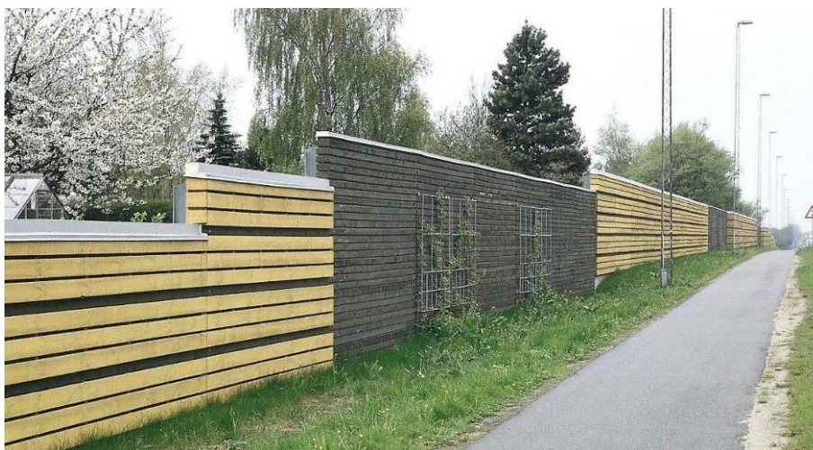
Rys. 14 Ekran przeciwhałasowy (drewniany)
