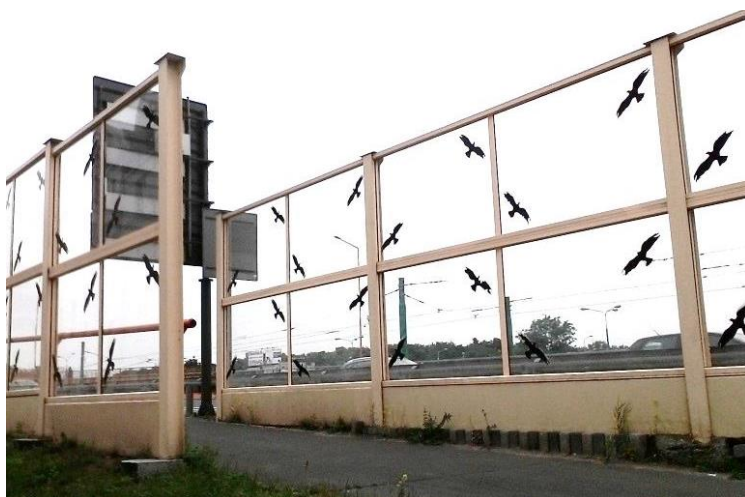
Rys. 15 Przezierny ekran przeciwhałasowy odbijający (na zakładkę)
