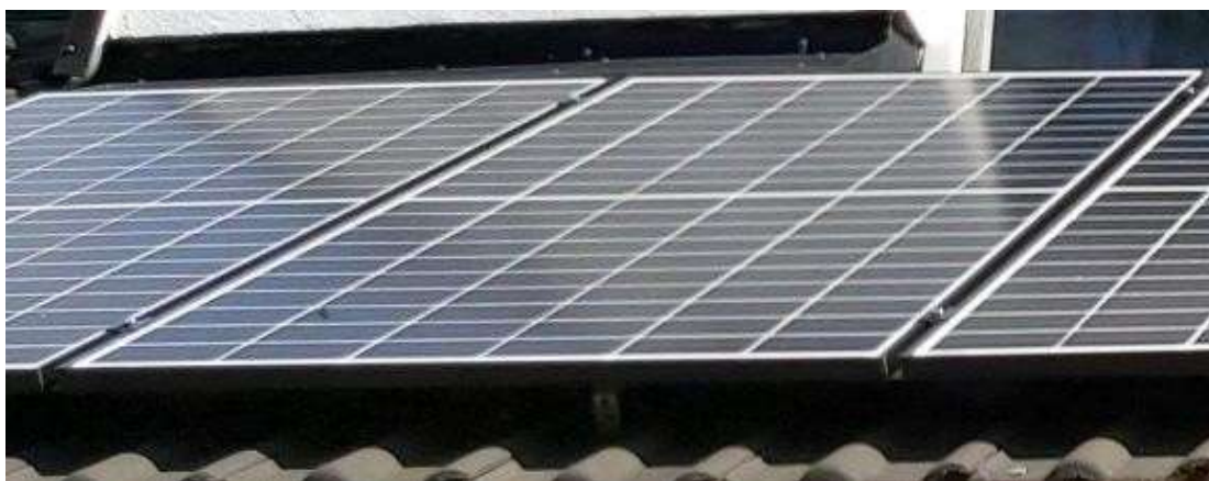
Zdjęcie paneli fotowoltaicznych
