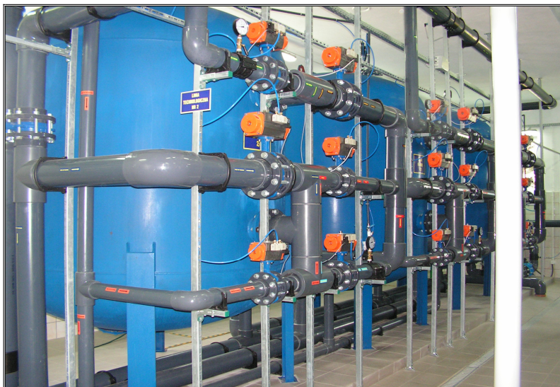
Rys. 6. Wodociąg Katarzynin - Stacja Uzdatniania Wody, filtry ciśnieniowe odżelaziające - odmanganiające
