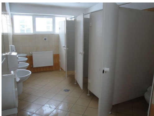
Rys. 7. Sanitariaty zewnętrzne w Gimnazjum Nr 1 w Wągrowcu
