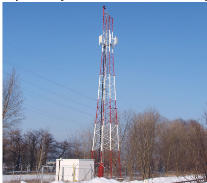
Rys. 2. Stacja bazowa telefonii komórkowej
