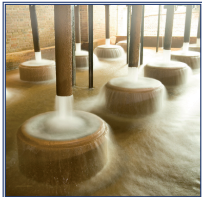
Rys. 5. Wodociąg Ostrów Wlkp. – Stacja Uzdatniania Wody, hala napowietrzania
