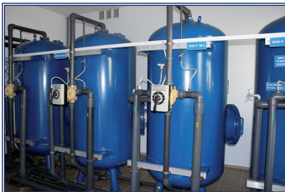
Rys. 15. Filtry odżelaziająco-odmanganiające, SUW Szpitala Powiatowego w Jarocinie
